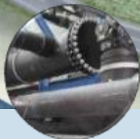
Enfriamiento de Agua
