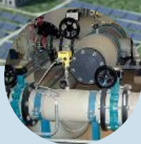
Desulfuración de Gases de Combustión
