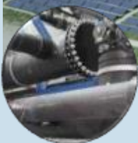
Enfriamiento de Agua
